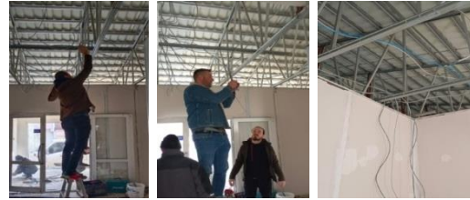
Çınarlı Mahallesinde yeni açılan kreşe internet bağlantısı, altyapı ve güvenlik kamerası sistemi
